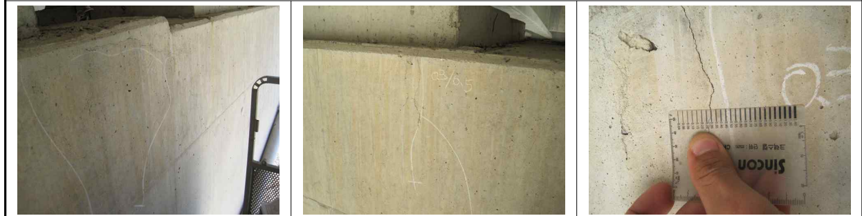
② 교각 P2 코평부 균열(0.3mm이상) - 진전 여부확인
