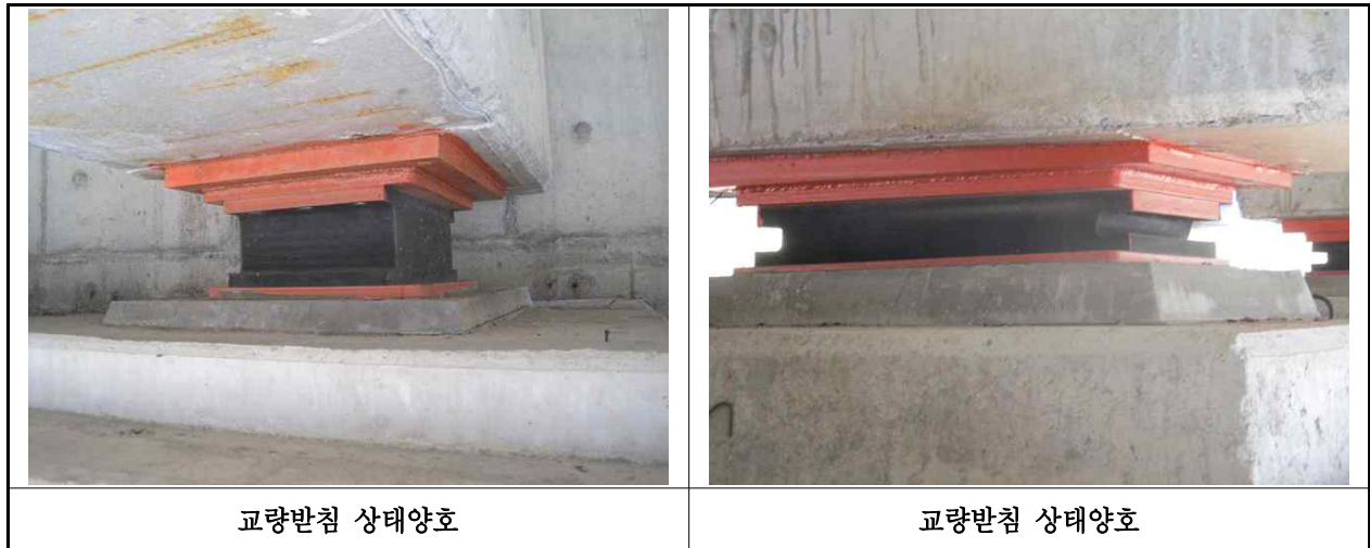
【사진 27.3.36】 교량받침 손상현황
