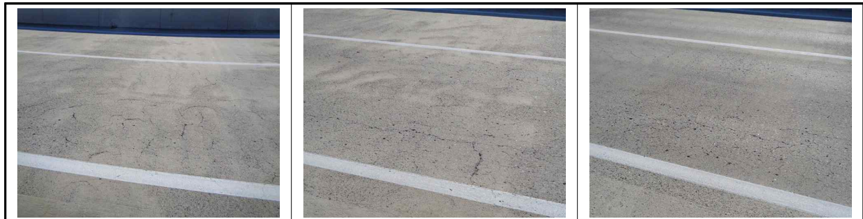
① 교면포장 망상균열 - 진전 여부확인
